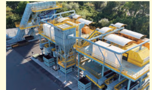
明海リサイクルセンター 非鉄金属選別ライン
