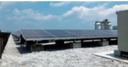
豊橋製造所 第一太陽光発電所 (2025年7月稼働)
