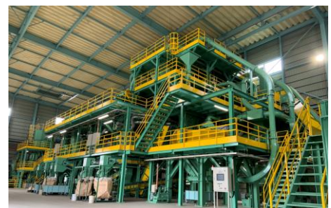
ダスト破碎選別設備
